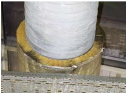
In Faserdämmstoffen können sich Staub und Schmutz festsetzen. Ist die Dampfsperre beschädigt, kann das Material leicht durchfeuchten und so zu einem idealen Nährboden für Schimmelpilze werden
